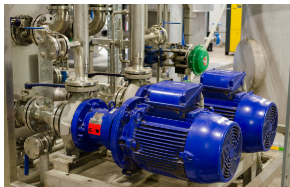
↑ Planta de Biogas
