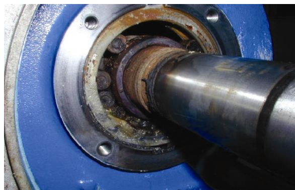
↑ Bomba Centrífuga en una Petroquímica
